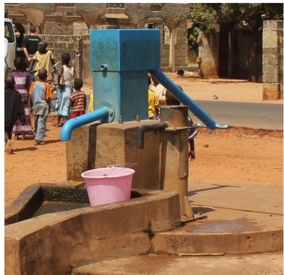
Un autre point d'eau durable et réhabilité
