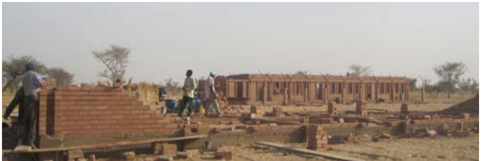
De school en de huizen voor de onderwijzers zijn in aanbouw in Ogoudengou
